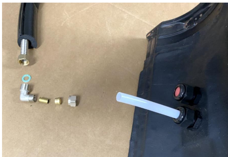
Figuur 22 – Montage RVS leiding aan Teflon leiding – met haakse koppeling
